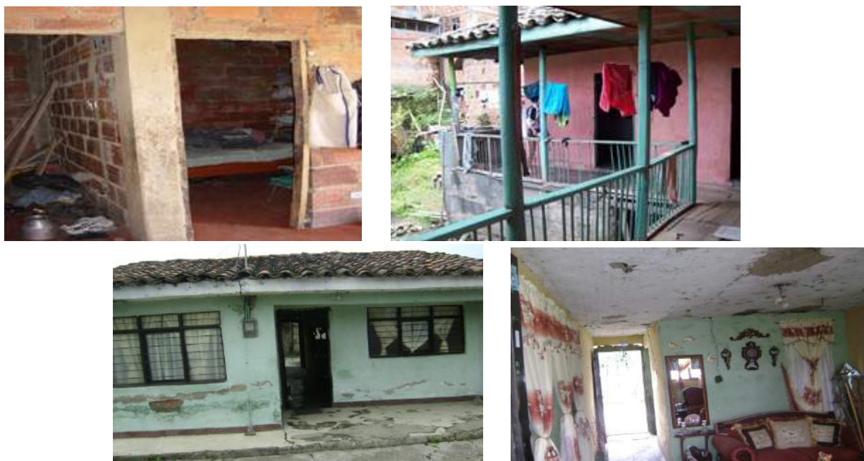
Figura 47: Ejemplos de Acabados principales en Mal estado de conservación
